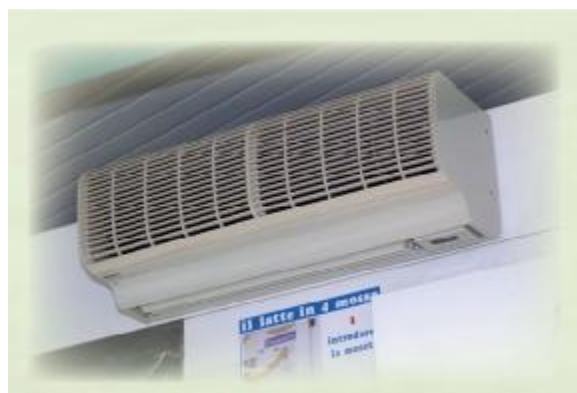
Ventilátor – vzduchová clona proti hmyzu
