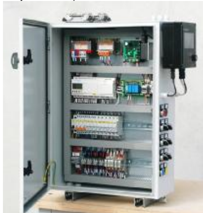
Elektrorozvodná skriňa - nezávislé napájanie a istenie obvodov
